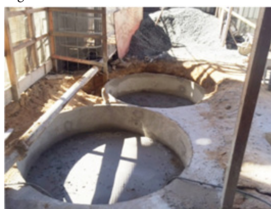
Figura 20 – Sistema de decantação para água de lavagem de betoneira
