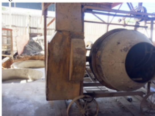
Figura 19 – Sistema de decantação para água de lavagem de betoneira
